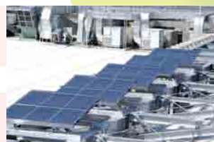
太陽光発電システム導入
