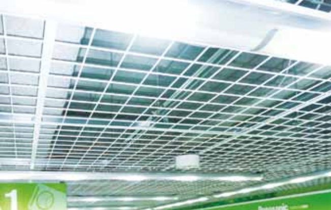
▲店舗内照明のLED化(LABI新宿西口館)
