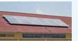
▲太陽光パネル
